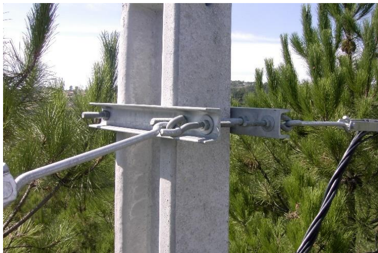
Fig. 4 – Pormenor da ferragem para fixação apoio de MT
